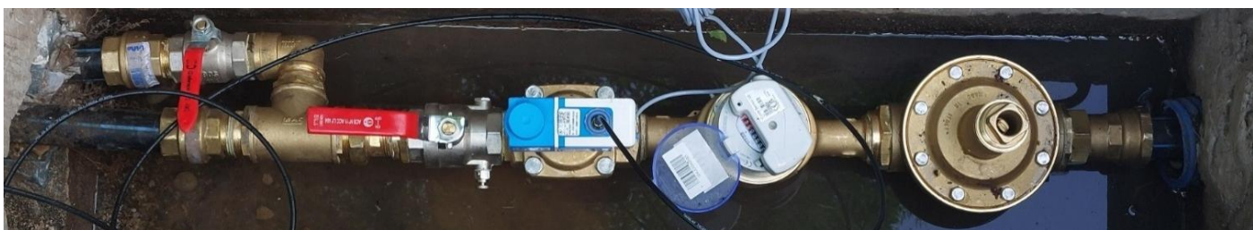
Installation d'un disjoncteur d'eau (dispositif central) afin de repérer les consommations d'eau atypiques et couper automatiquement l'eau en cas de fuite importante (crédit photo ville d'Aix)
